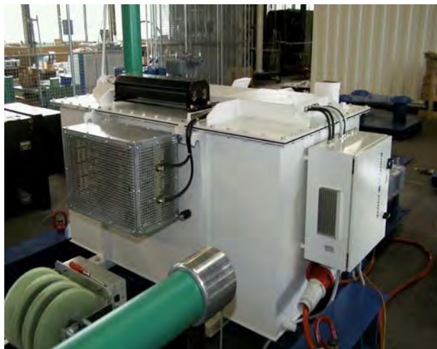
Charging rectifier 200 kV, 60 mA
