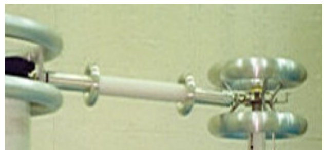
300kV試験システムの保護抵抗器
